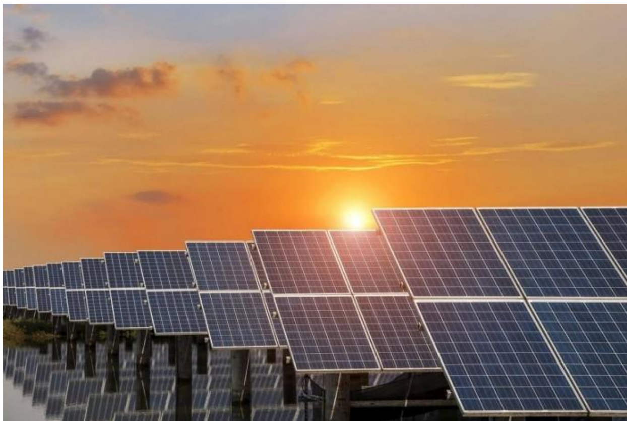
Рисунок 2. Солнечная фотоэлектрическая установка
